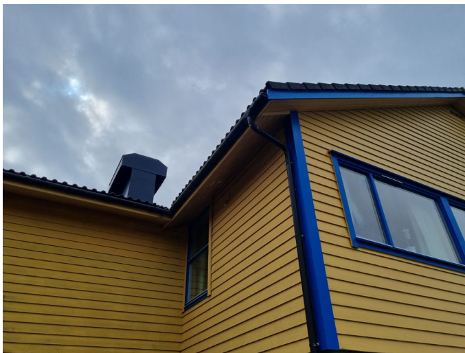
Foto 13 maling flassar av under gesims – lekkasje i taktekking
