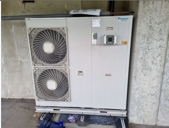
Foto 7 varmepumpe luft/vatn - utedel
