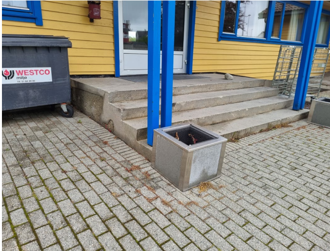
Foto 29 her manglar rekkverk og handløpar
