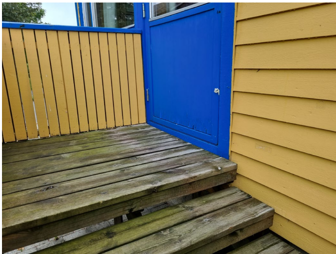
Foto 27 råteskade på terrassedør
