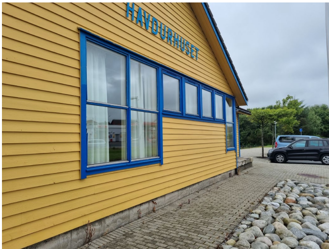
Foto 17 fasade der vindauga er sterkt råteskadd
