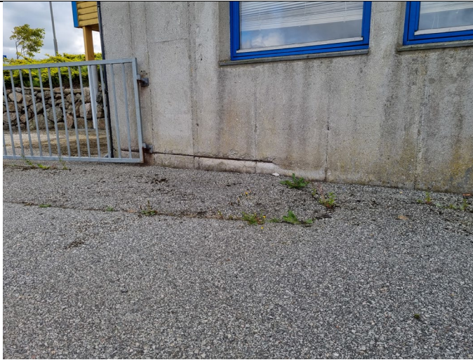
Foto 35 korrosjon av armering med følgeskade på betong
