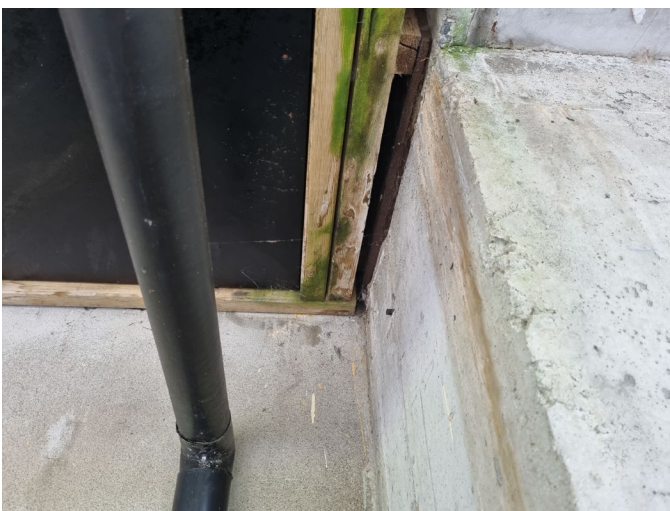
Foto 11 skade etter lekkasje når taknedløp er tett
