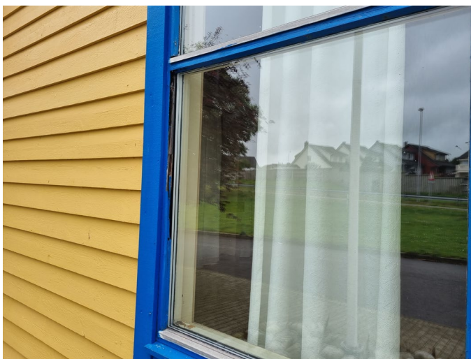
Foto 20 rådeskade på vindauge
