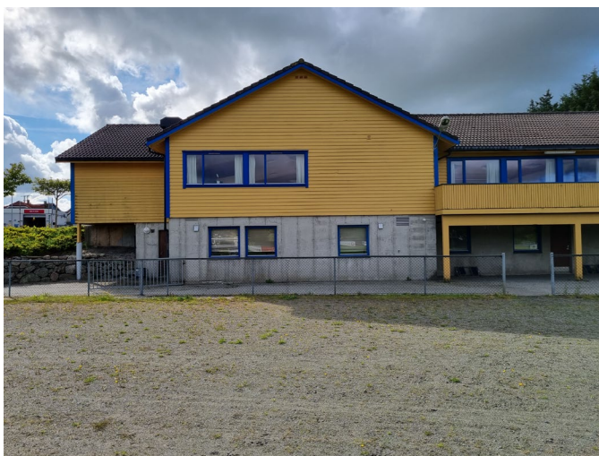
Foto 23 Fasade mot nord er 2 vindauge må utvidast
