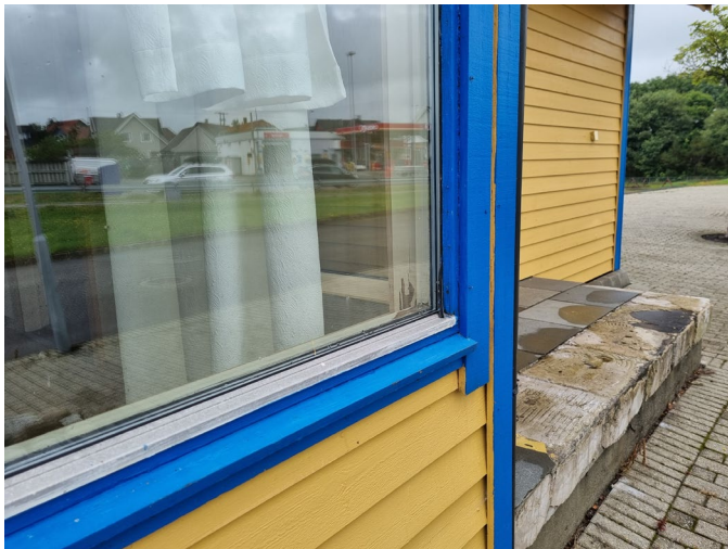
Foto 34 Platting/rampe som manglar heller/fliser
