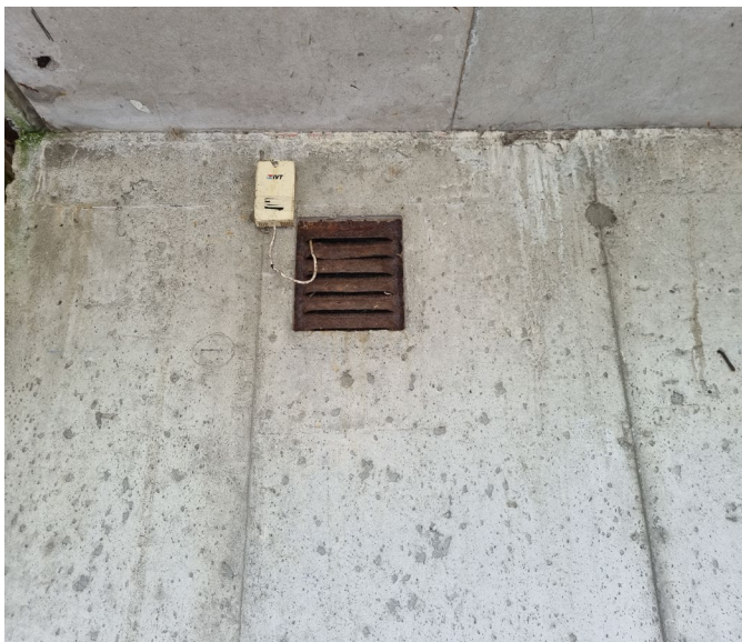
Foto 15 eksempel på korrosjon på veggventil
