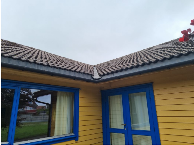
Foto 14 ulike type takstein og slitasje på sløys
