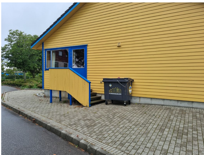
Foto 28 Dør, trapp og repos som må skiftast ut
