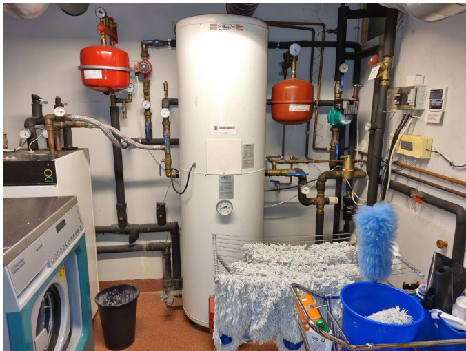
Foto 8 varmepumpe innedel – vassboren varme
