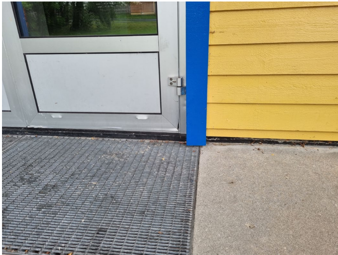
Foto 24 skade etter innbrotforsøk på ytterdør
