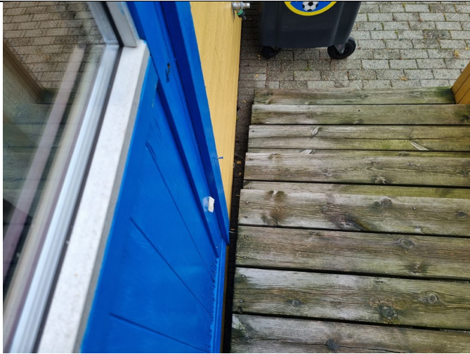
Foto 26 trapp og repos er i ferd med å skli ut frå veggen
