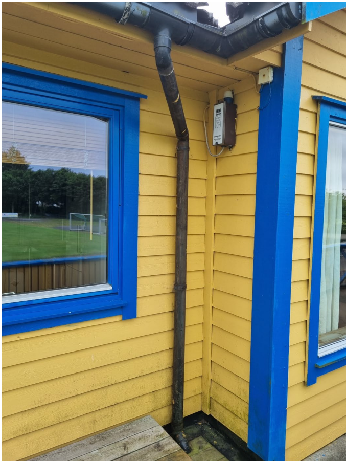
Foto 12 taknedløp som er tett
