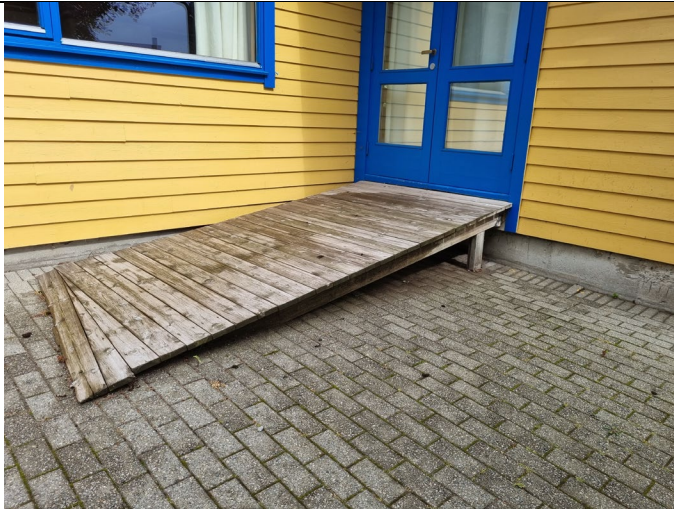
Foto 31 også denne rampa må ha sikring for rullestolbruk
