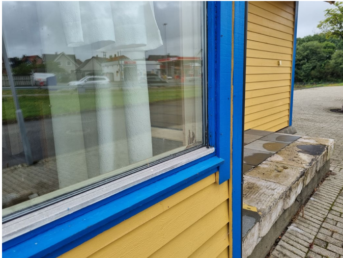
Foto 19 råteskade på vindauge
