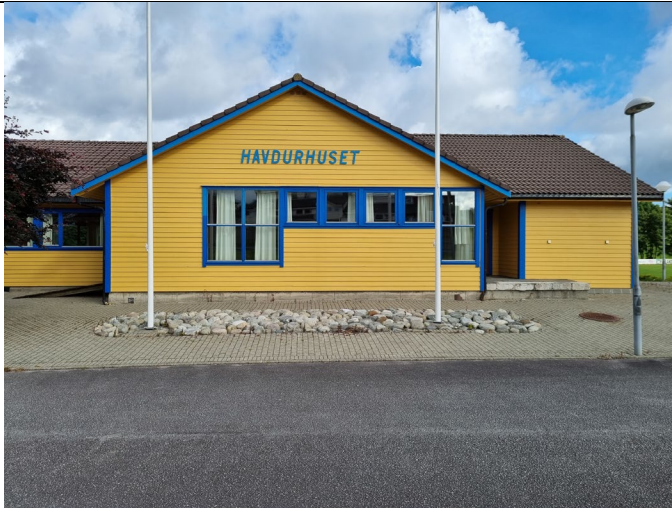
Foto 21 Fasade der vindauge må skiftast
