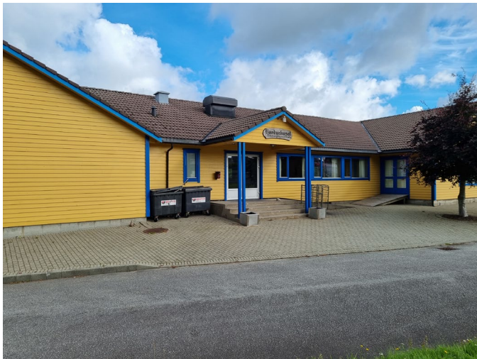
Foto 22 eksempel på overflødige takhattar og ventilar
