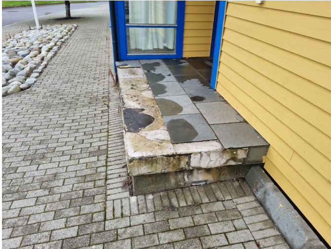
Foto 33 fliser/heller manglar på platting/rampe
